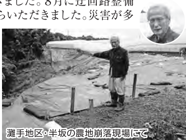
灘手地区・半坂の農地崩落現場にて
